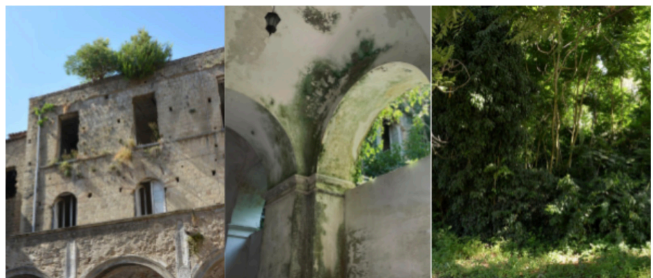
Figura 1 | Rotture, Efflorescenze, Vegetazione – Ex Ospedale psichiatrico La Maddalena, Aversa. Fonte: Foto di Lucia Ludovici e Ilaria Maurelli.
