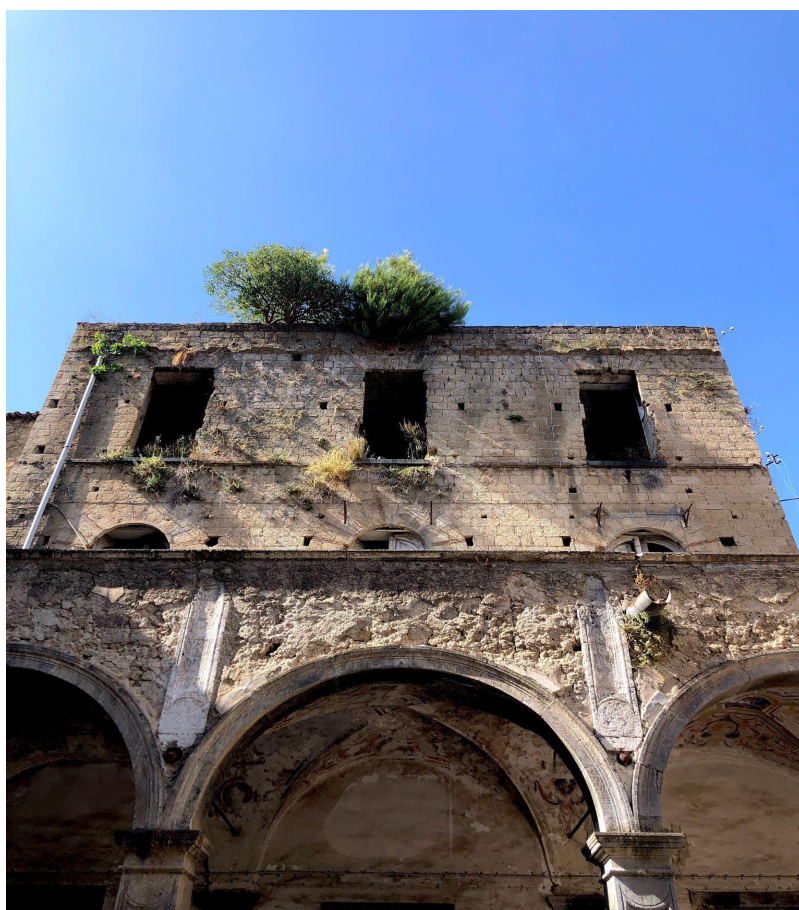
Figura 4 | Una parte del chiostro dell’ex-Ospedale Psichiatrico della Maddalena, dove si legge sia una certa assenza di cura che il potenziale di memoria da tutelare. Fonte: Eléonore Jactat.
